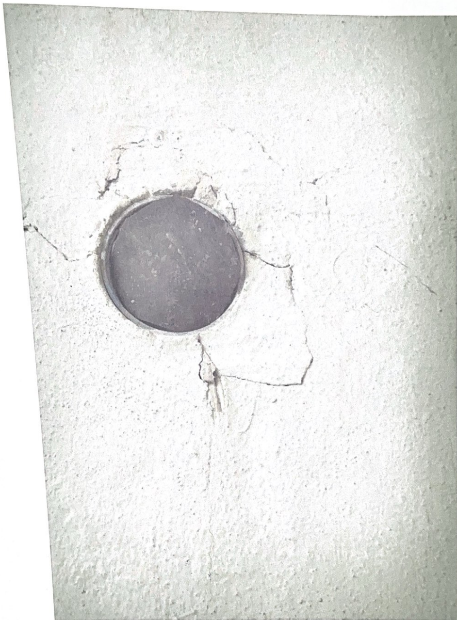
ПОДВАЛ СКРУТКА ЗАКРЫТАЯ
